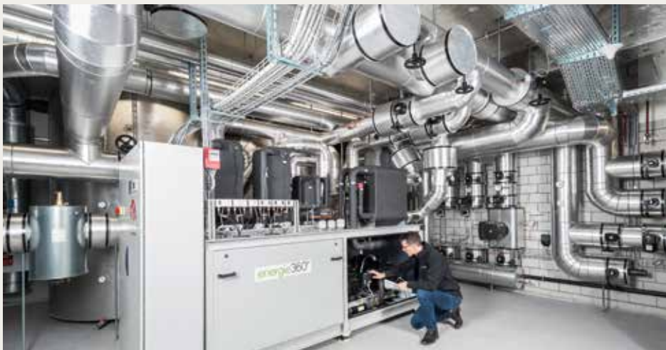
Vorbildlich: Die Heizungsanlage in Knies Kinderzoo funktioniert mit Abwärme aus dem See.
